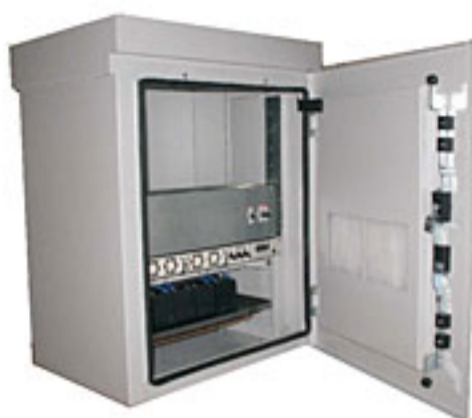
PS48-0030 (2/0800-1U) В ШКАФУ ШТК-100
