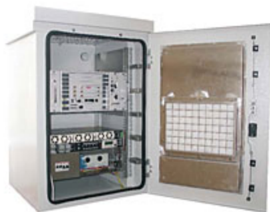
PS48-0045 (3/0800-2U) В ШКАФУ ШТК-100С
