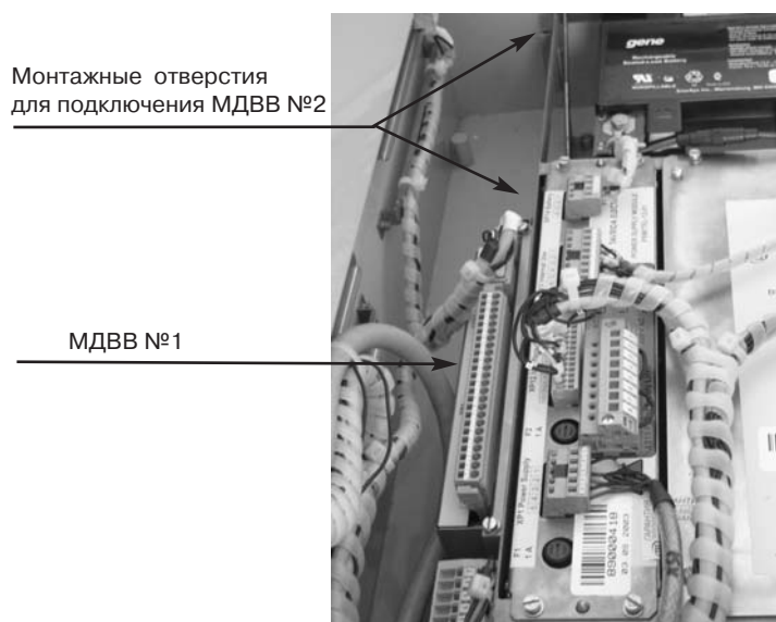
Рис. 3.20. Установка МДВВ в шкафу управления
