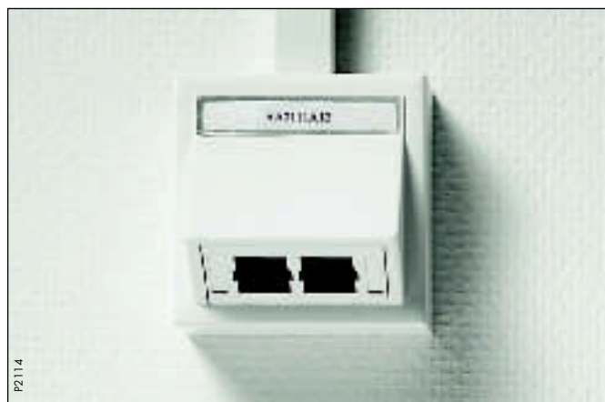
Розетка CYB, смонтированная на стене.
