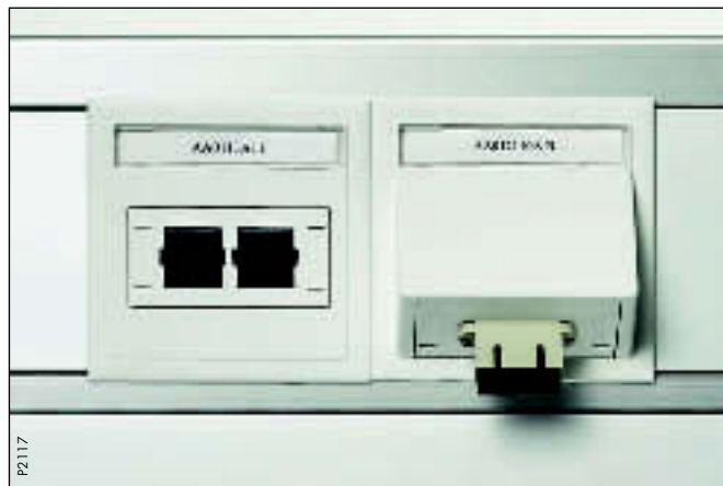
Розетка CYB, смонтированная на кабель-канале.
